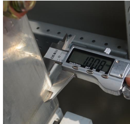
主开关出线母排厚度
